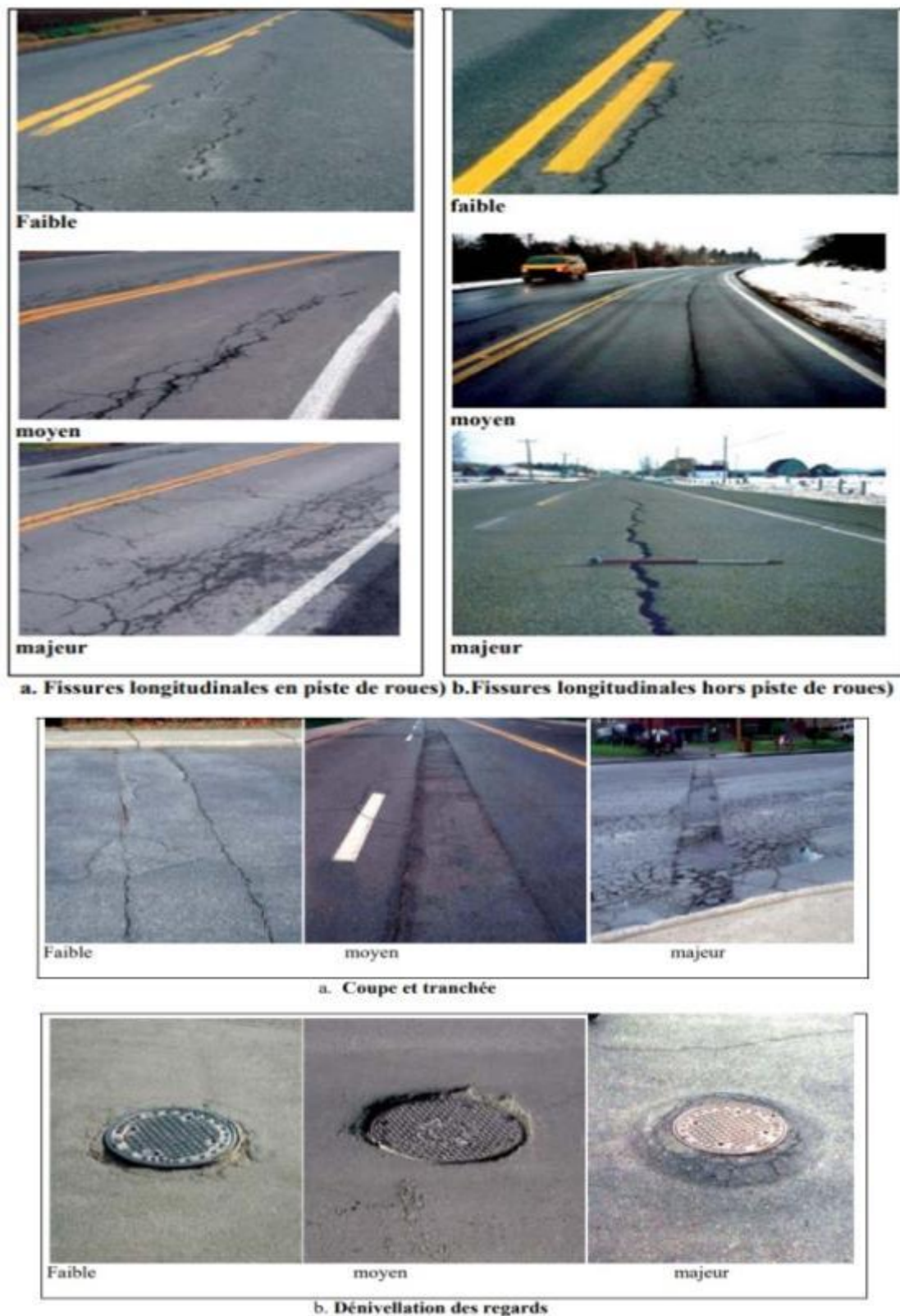
Figure 2.3 : Types de dégradations observées sur les chaussées bitumineuses algériennes [47]
