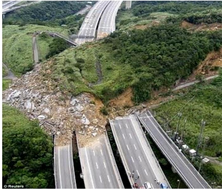
Figure (3.6) Glissement de terrain a Taiwan
