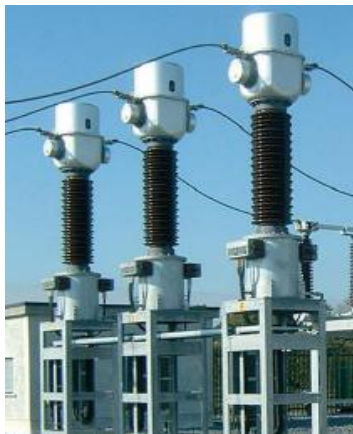
(a) Transformateur de courant
