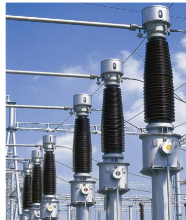
(b) Transformateur de tension
