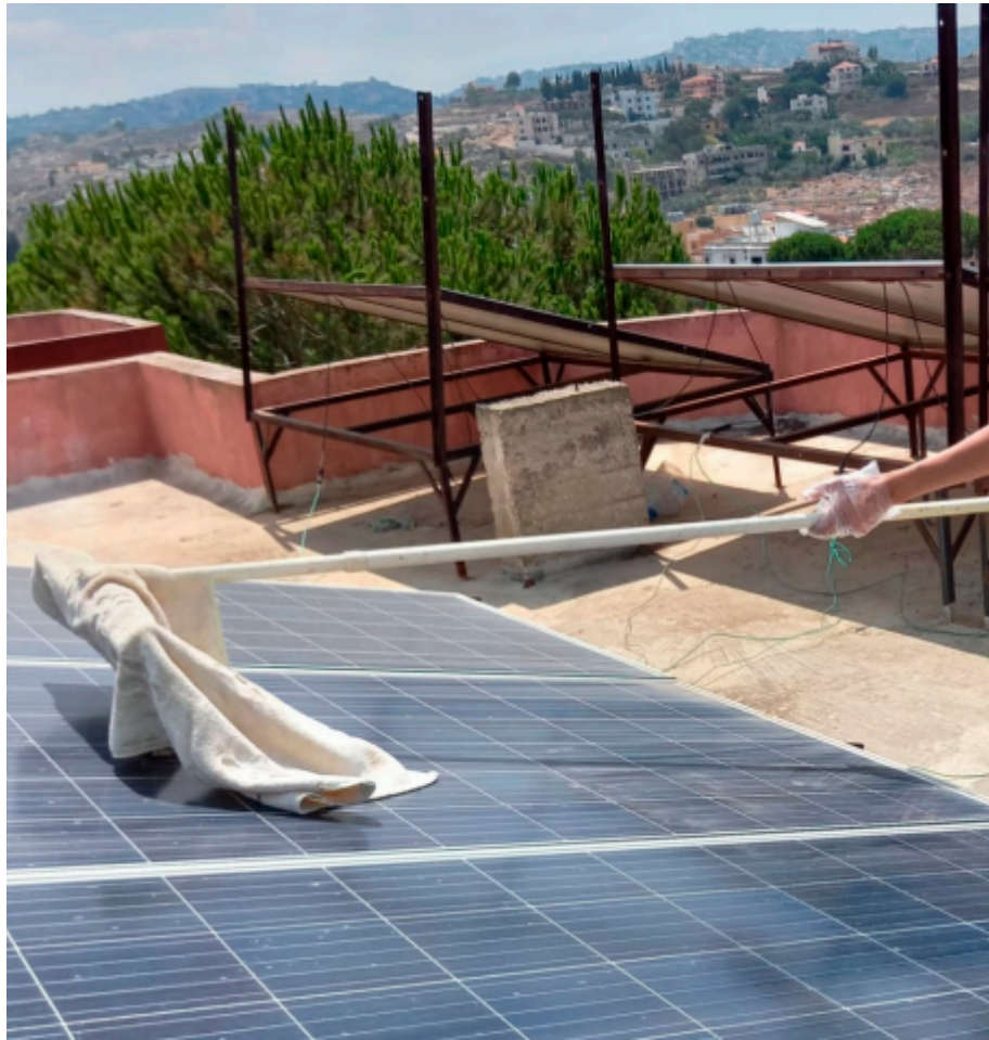
Figure II. 25 : Nettoyage manuel des panneaux PV [80].
