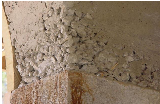
Figure 11 : Ségrégation du béton
